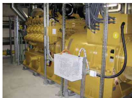
Blockheizkraftwerk (BHKW): Zwölfzylinder-Gasmotor und Generator, Wärme- und elektrische Leistung je 1.2 MW.
