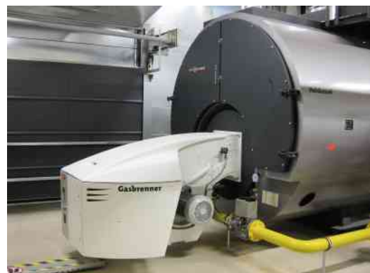
Gas-Heizkessel mit 6 MW Wärmeleistung: Elco-Brenner, Viessmann-Kessel.
