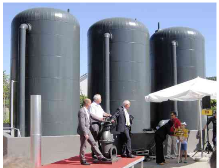
Letzte Vorbereitungen für den Eröffnungs-Akt vor den drei Wärmespeichern mit je 100 m 3 Inhalt.
