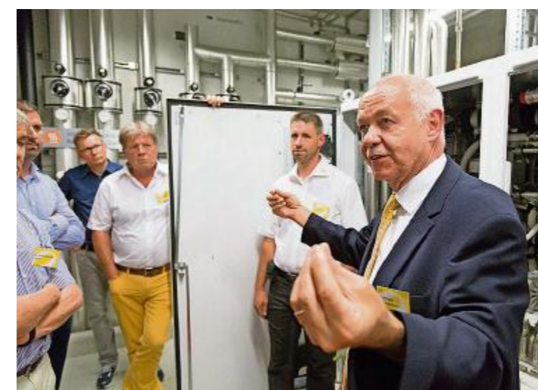
Regio-Energie-Direktor Felix Strässle erklärt die Funktionsweise des Elektrolyseurs.
