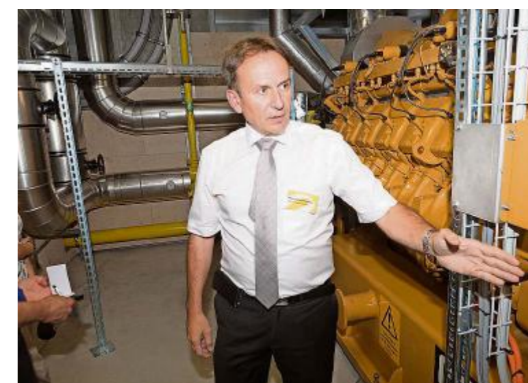
Marcel Rindlisbacher, Geschäftsleitungsmitglied im Bereich Netze bei der Regio Energie Solothurn, neben dem Blockheizkraftwerk.
