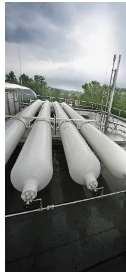
Wasserstoffspeicher auf dem Dach.
